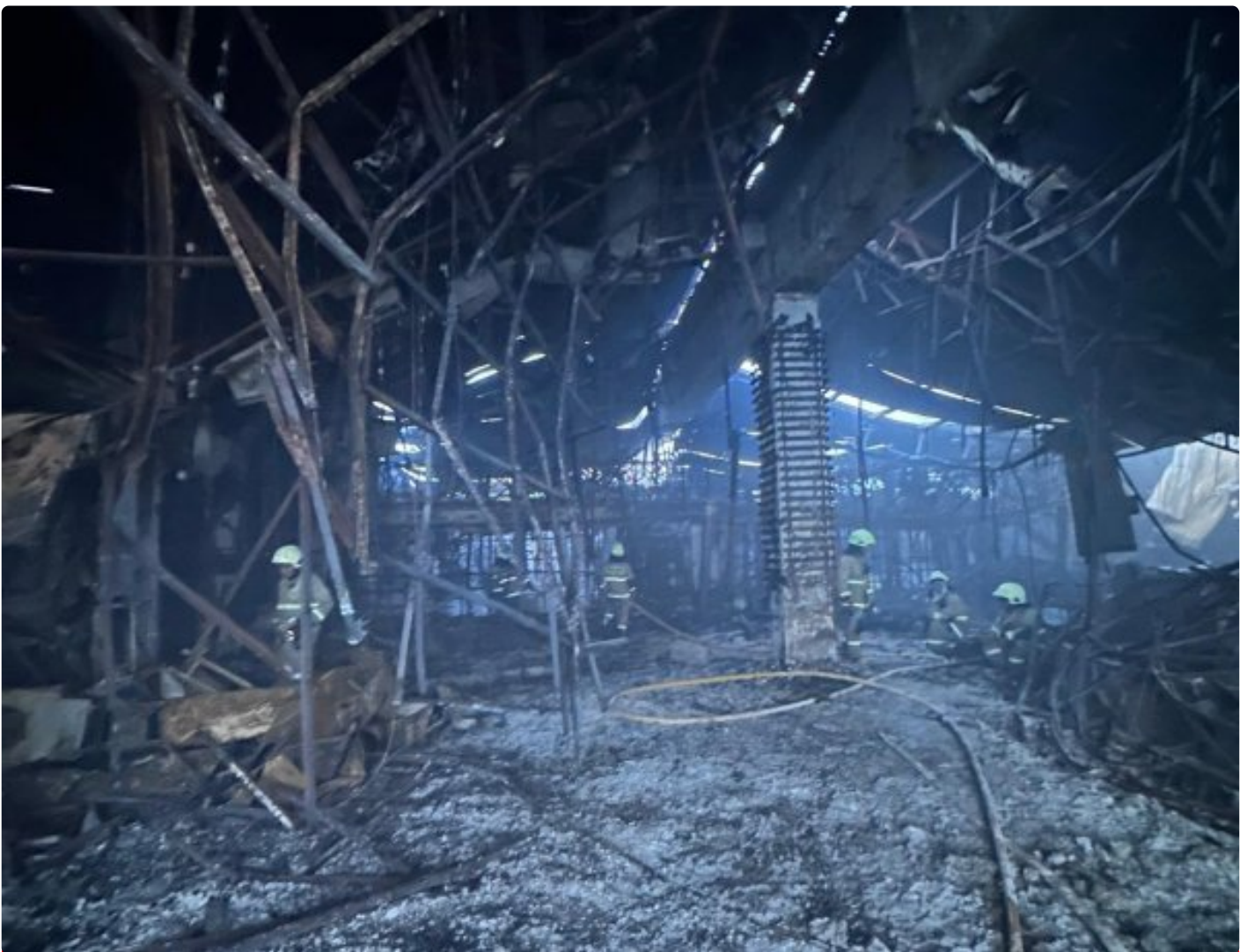
Glodok Plaza yang Hangus Terbakar
